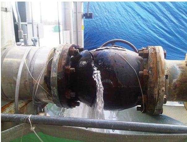
A 2011. évi texasi hidegben eltört tűzvíz vezetéki zárószerelvény [12]
