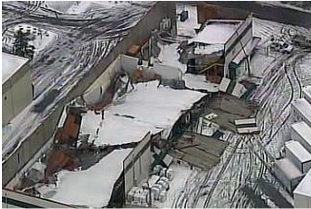
Üzemi épületek beszakadt tetőszerkezetei [1]
