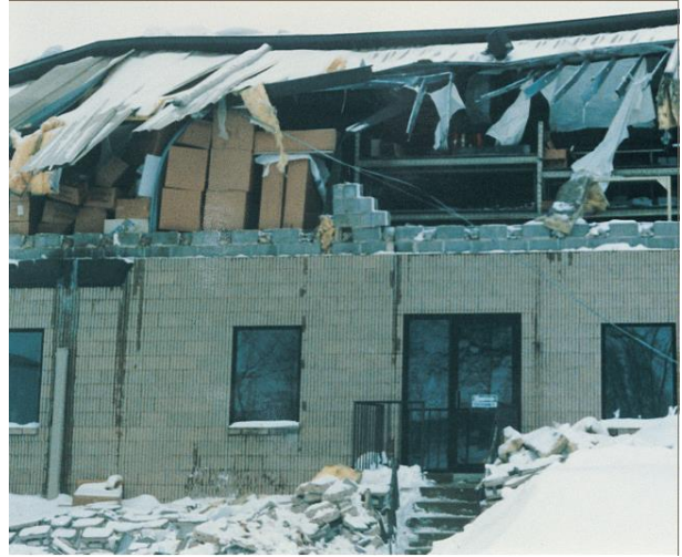
Téli viharban megrongálódott tetőszerkezet [9]
