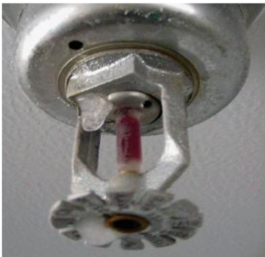
Elfagyott sprinkler szórófej [8]
