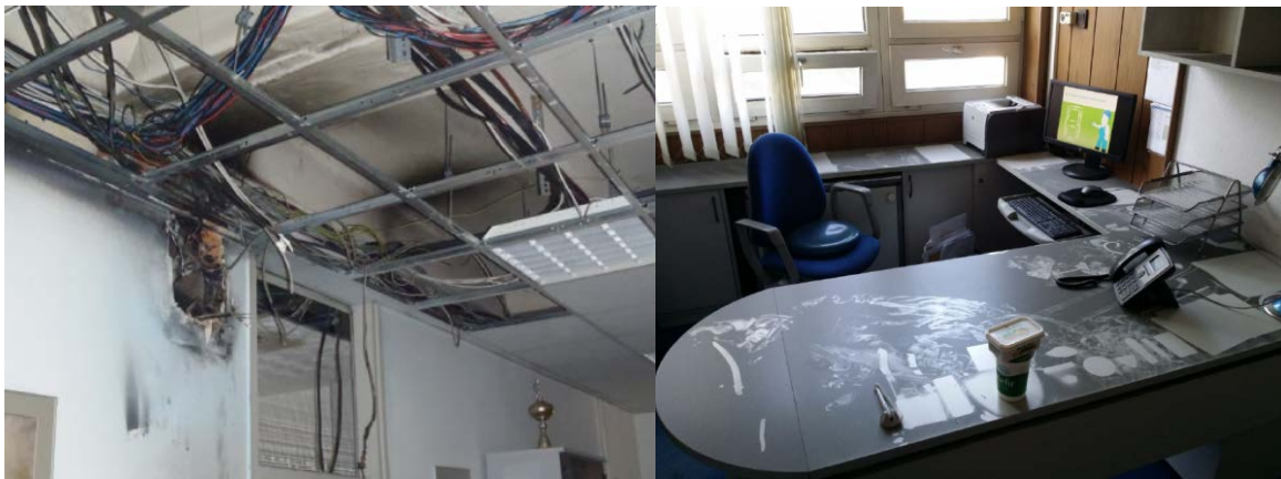
A kigyulladt elosztó környezetének koromszennyeződése
